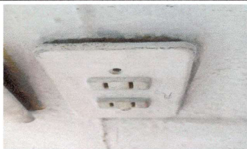
Foto 10: toma corrientes en mal estado y algunos sin funcion
