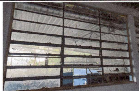
Foto 4: las ventanas se encuentran en mal estado.
