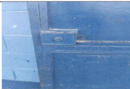
Foto1: se cambiara la chapa ya no es funcional.
