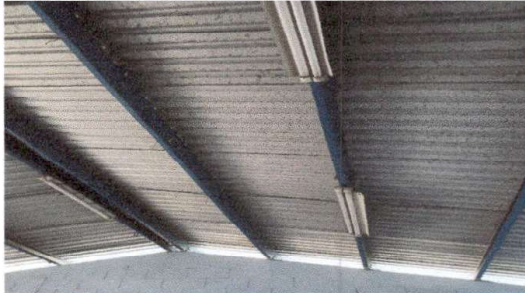
Foto 8: las lamparas no funcionan solo una bombilla dentro del aula.
