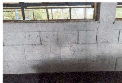
Foto 6: muro interior se encuentra sucio y da mal aspecto.
