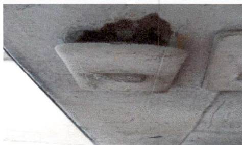
Foto 10: interruptores en mal estado
