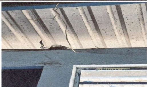
Foto 9: cables mal instalados
