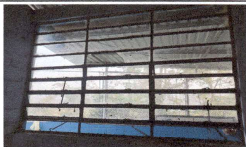
Foto 3: vidrios rotos, por el tiempo que tienen se despegan los vidrios completos, 12 ventanas en mal estado
