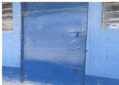
Foto 2: la puerta cuenta con pasadores que no tienen funcion.
