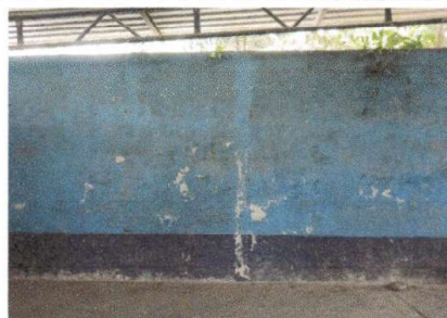
Foto 5: muro exterior se encuentra en mal estado.
